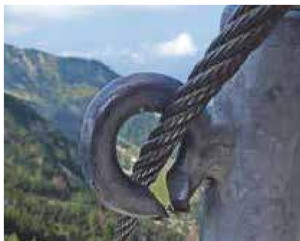
Slika 44: Sistem sidranja z očesnimi sidri in preslabo napeta jeklena vrv, ki je nevarno poškodovala oko sidra.
