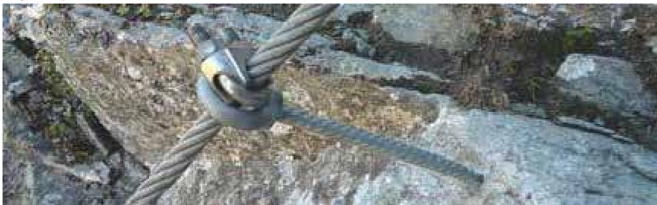
Slika 36: Uporaba neatestiranih očesnih matic brez prečne nosilnosti; Glede na premer sidra je njena zunanja dolžina opazno prevelika, obstaja velika verjetnost utrujanja materiala; neprimerna uporaba spojke za jekleno vrv.
