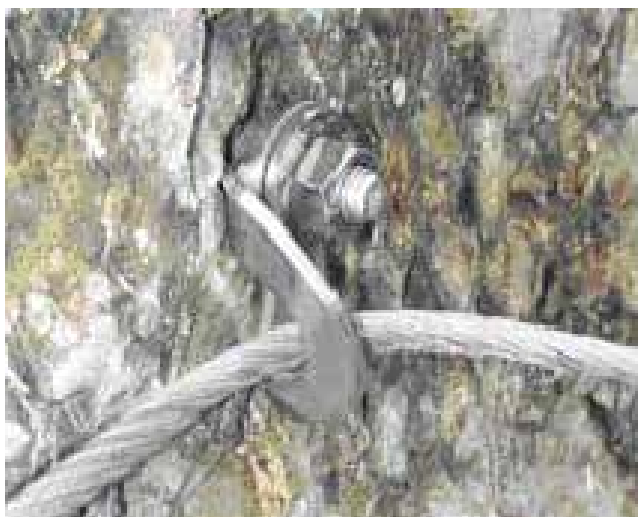
Slika 41: Jeklena vrv se dotika stene, neznana varnost sistema, fiksiranje jeklene vrvi na nestandardizirano sidro, ki bo poškodovalo jekleno vrv.
